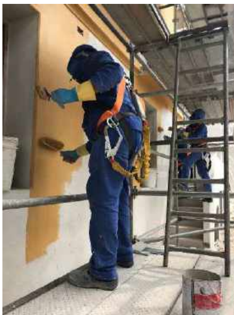
Foto 25 – Pintura lisa da fachada principal – Casa 06
