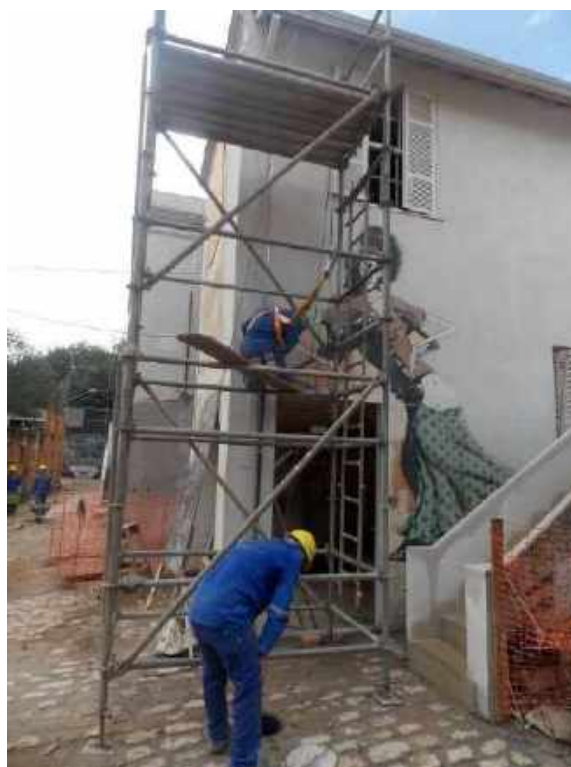
Foto 02 – Descidas do SPDA na fachada lateral – Casa 05
