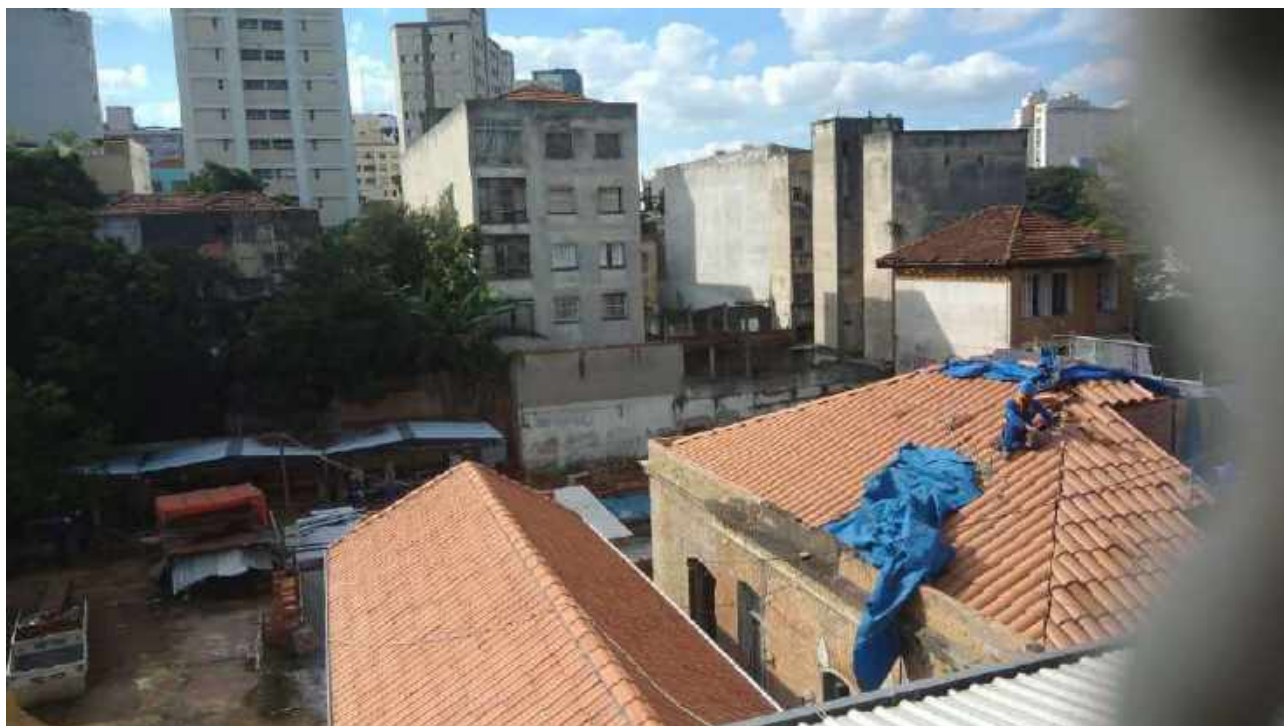
Foto 71: Chumbamento da cummeira.
