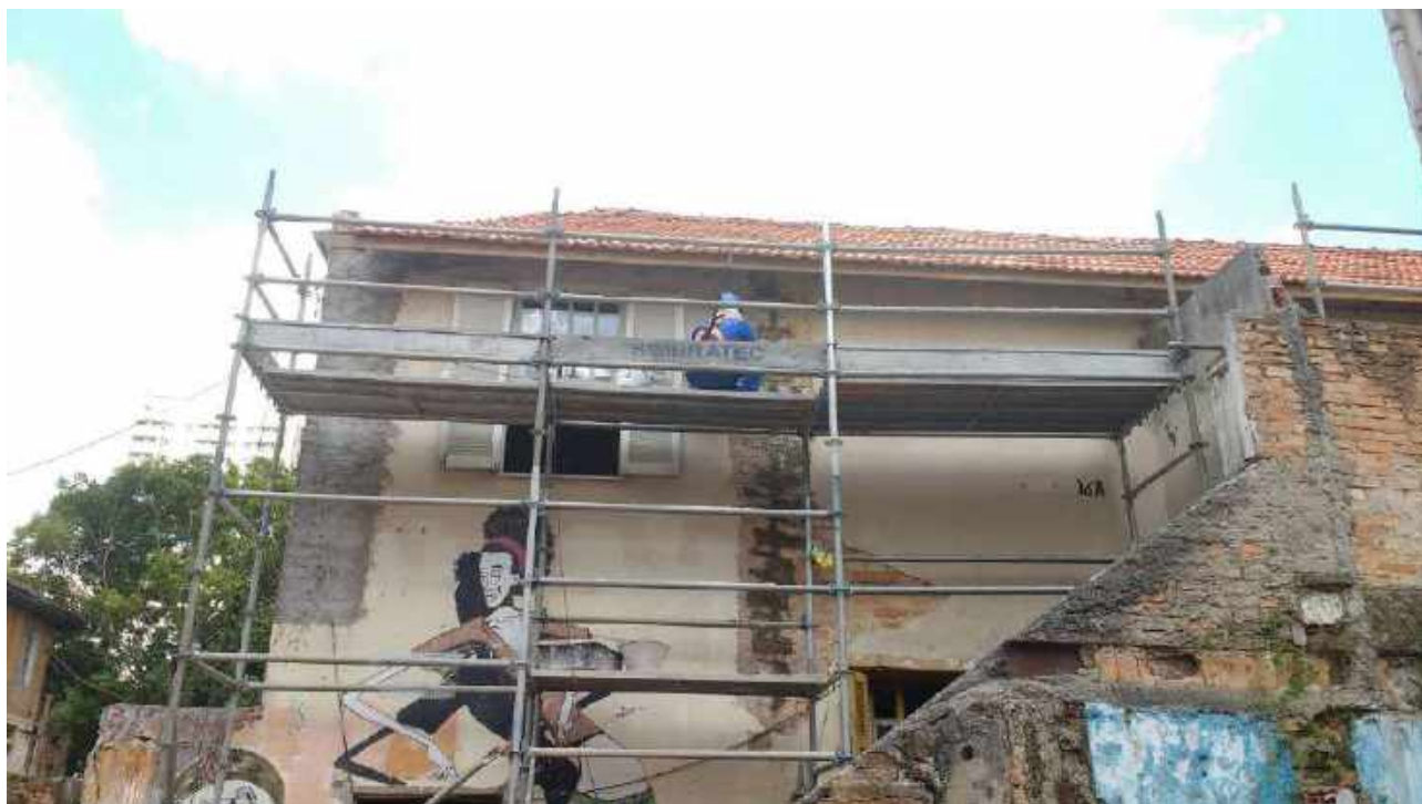
Foto 03: Tratamento das trincas.
