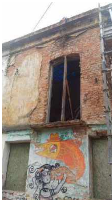
Foto 07: Escoramento das trincas das vergas da Casa 6.
