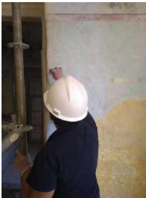
Foto 21 – Processo de envelhecimento das paredes internas – Casa 06
