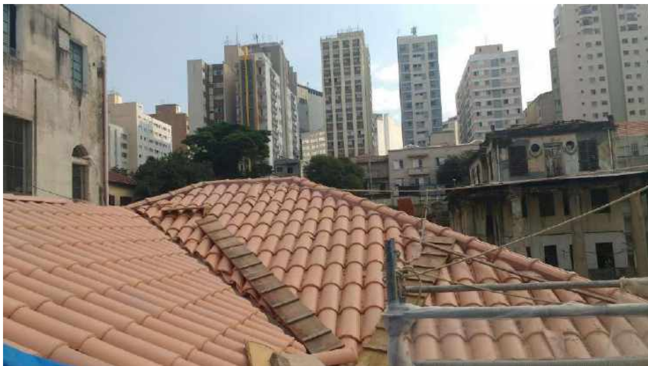
Foto 19: Chumbamento da cummeira.
