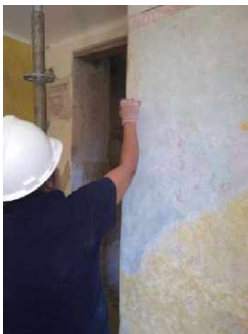
Foto 22 – Processo de envelhecimento das paredes internas – Casa 06
