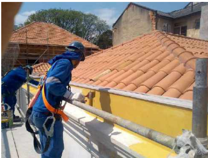
Foto 26 – Pintura lisa da fachada principal – Casa 06
