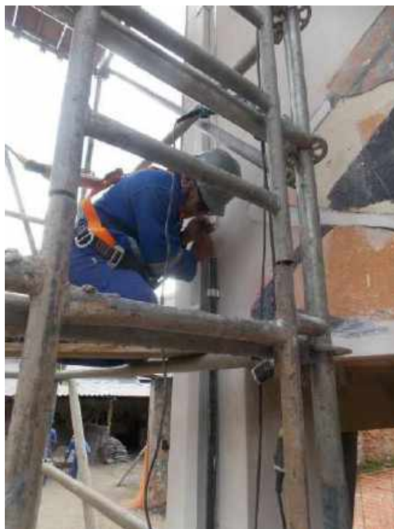
Foto 01 – Descida do SPDA na fachada lateral – Casa 05
