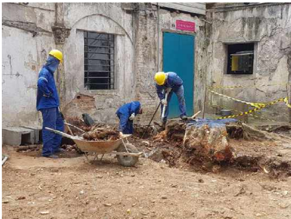
Foto 47 –Destroncamento das raízes da árvore da Casa 8
