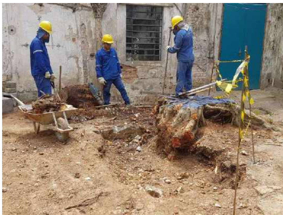
Foto 48 –Destroncamento das raízes da árvore da Casa 8
