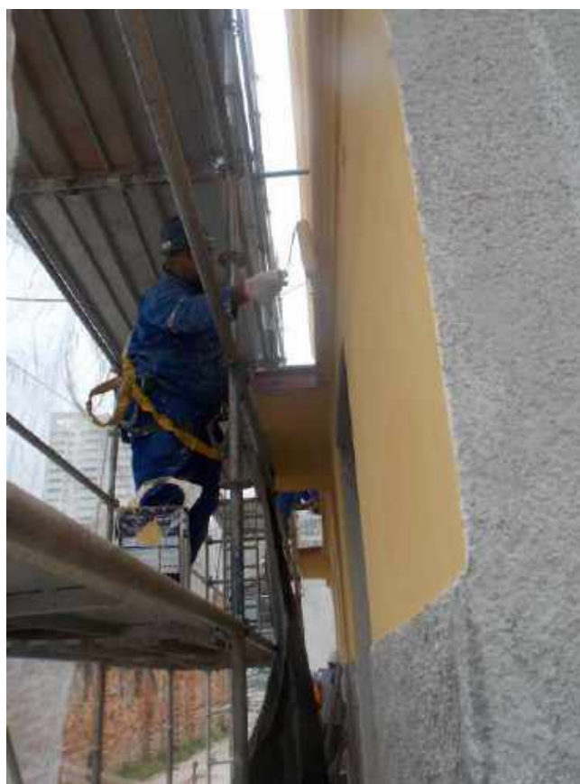
Foto 16 – Pintura lisa da fachada principal – Casa 06
