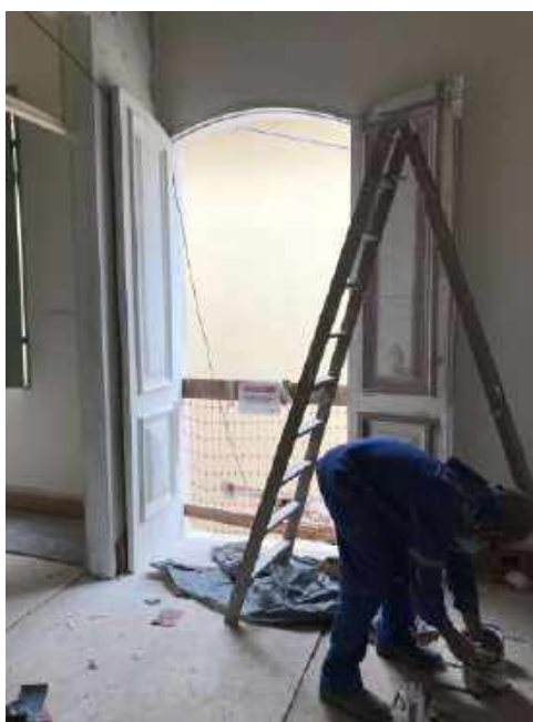
Foto 24 – Regularização das portas de madeira – Casa 06
