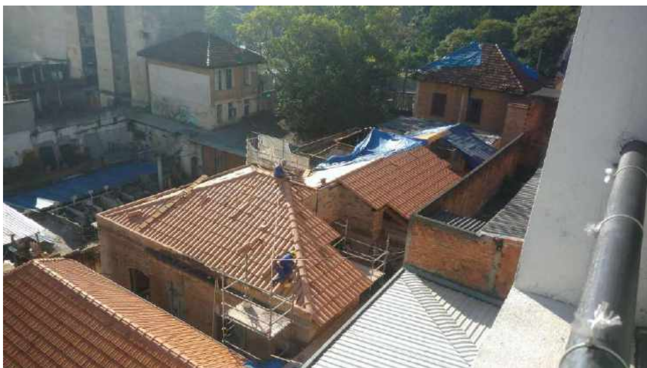
Foto 72: Chumbamento da cummeira.
