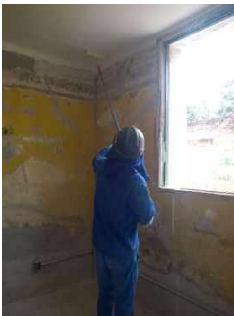
Foto 38 – Pintura lisa do forro – Casa 06
