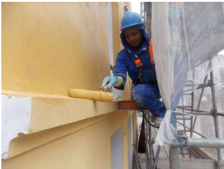
Foto 15 – Pintura lisa da fachada principal – Casa 06
